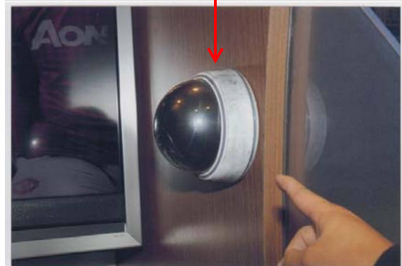
カメラの設置状況
